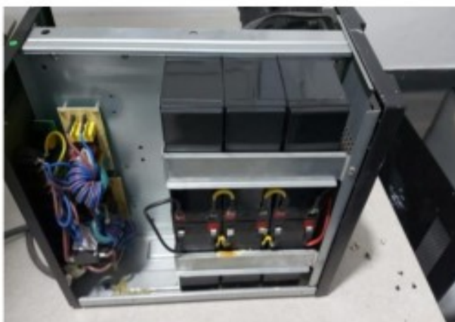
Ups con baterías sulfatadas a cambiar
