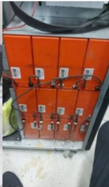
Baterías a remplazar
