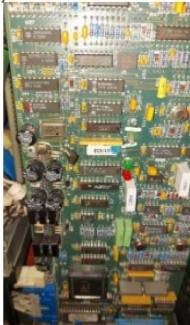
Tarjeta rectificadora e inversor afectada
