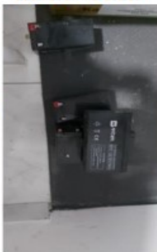
Baterías en mal estado
