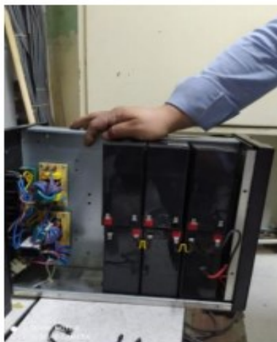
UPS EN MANTENIMIENTO
