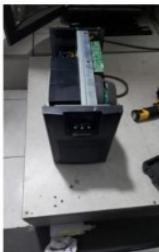
Ups en mantenimiento
